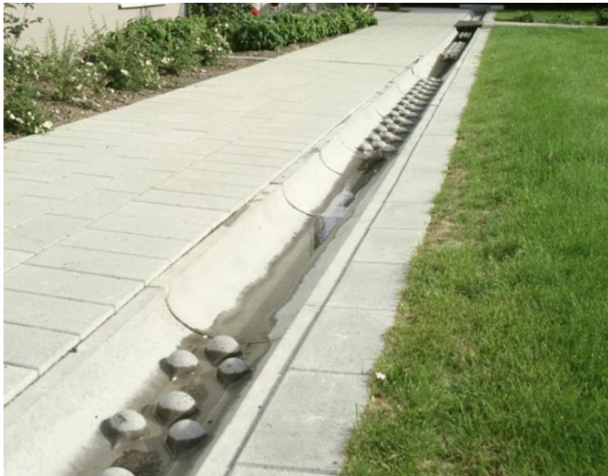
Figur 17. System med breda dagvattenkanaler för öppet dagvattensystem, de lökformade kupolerna ökar vattnets strömningshastighet samt leder till en förbättring av rensningen i rännan vid låga vattenflöden. (St: Eriks, 2016)
